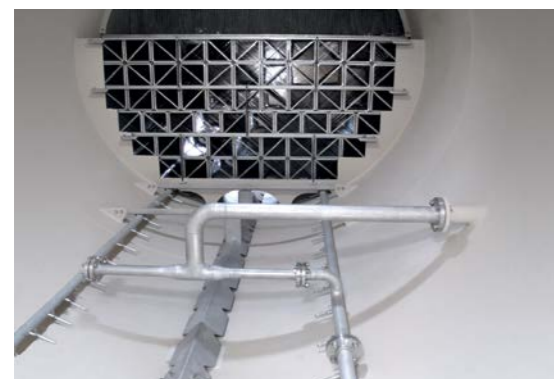
Paquetes de placas coalescentes con limpieza a chorro de arena
