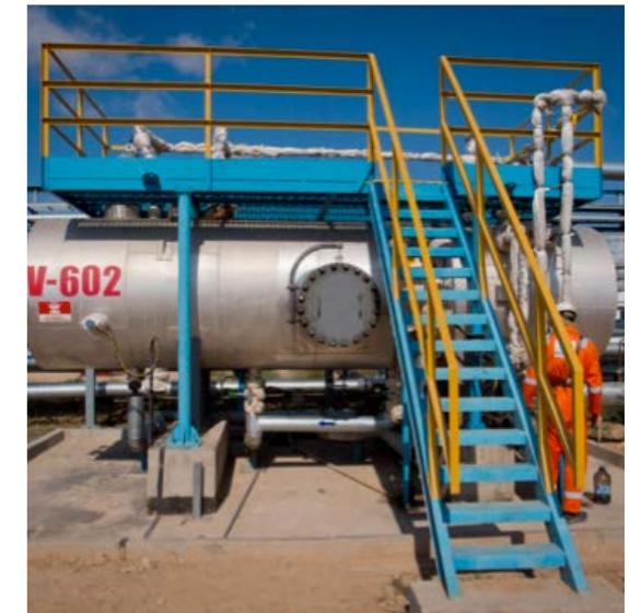
Recipiente de flotación de gas inducida
