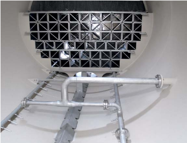
Paquetes de placas coalescentes con limpieza a chorro de arena
