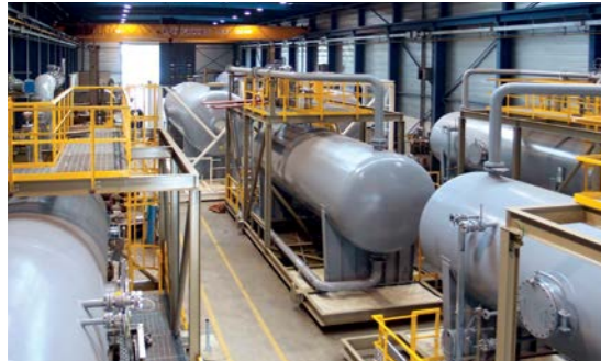
Separadores de 3 fases montados sobre patines
